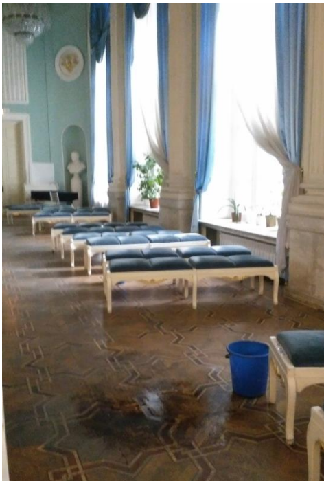
公演前日リハーサル中の雨漏り
